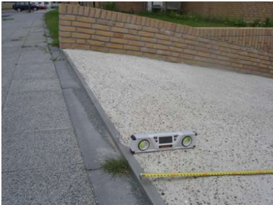
Foto 7- Hellingbaan 3, extra opgestort gedeelte aan de bovenzijde, zeer korte overgangshelling, rand ter plaatse van overgang helling naar horizontaal deel (stoeptegels liggen iets lager dan bovenkant hellingbaan)
