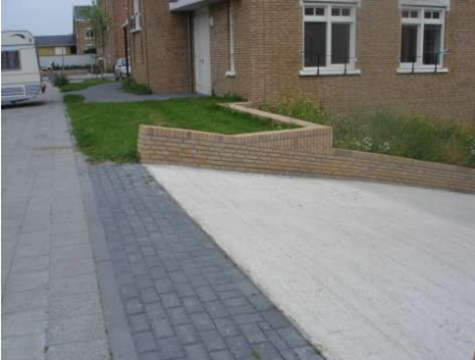
Foto 9 – Hellingbaan 4, extra opgestort gedeelte aan de bovenzijde, zeer korte overgangshelling
